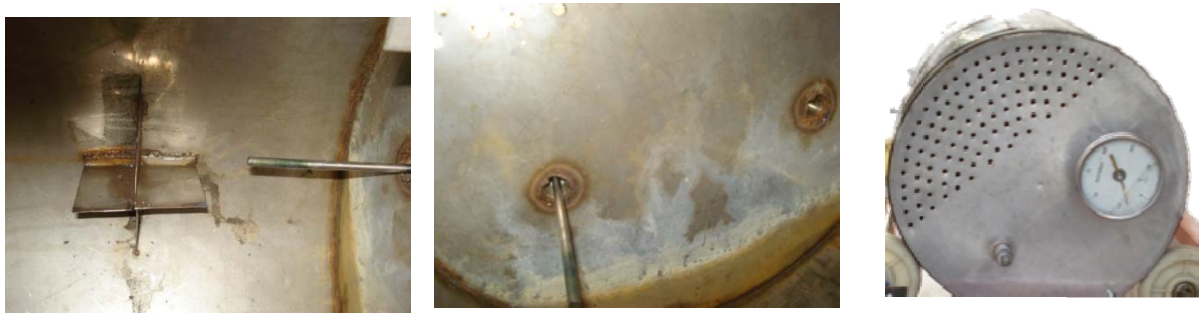
Imagen 2-10 Vista de baffle y sensor de temperatura
