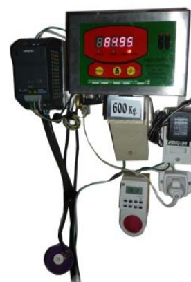
Imagen 2-16 Display de Balanza, y Control del Mecanismo de Rotación
